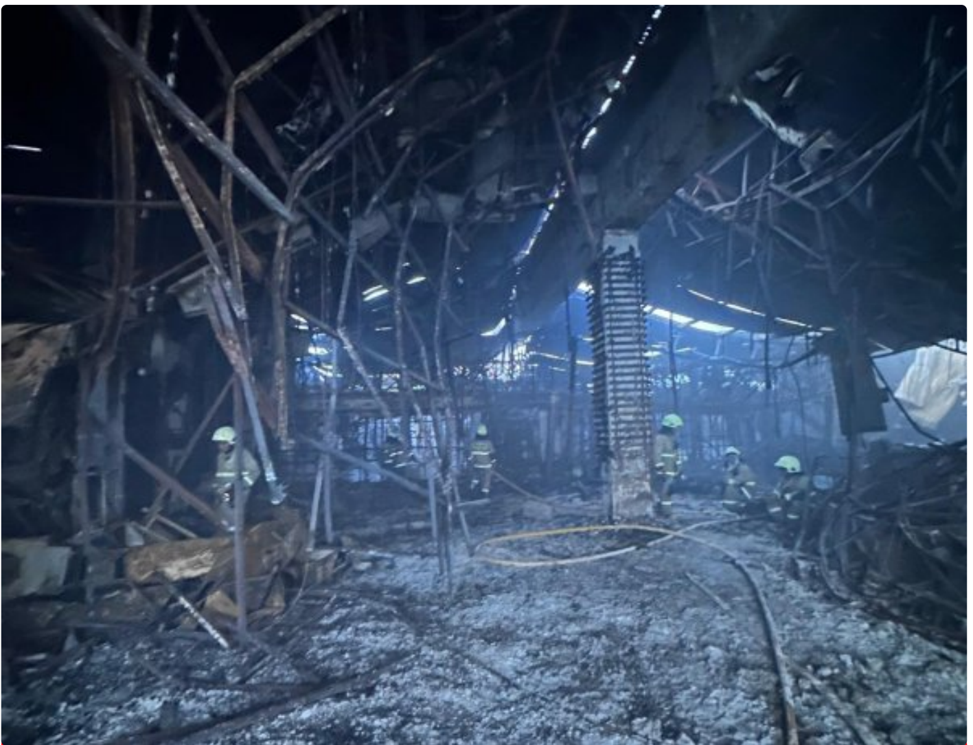
Glodok Plaza yang Hangus Terbakar
